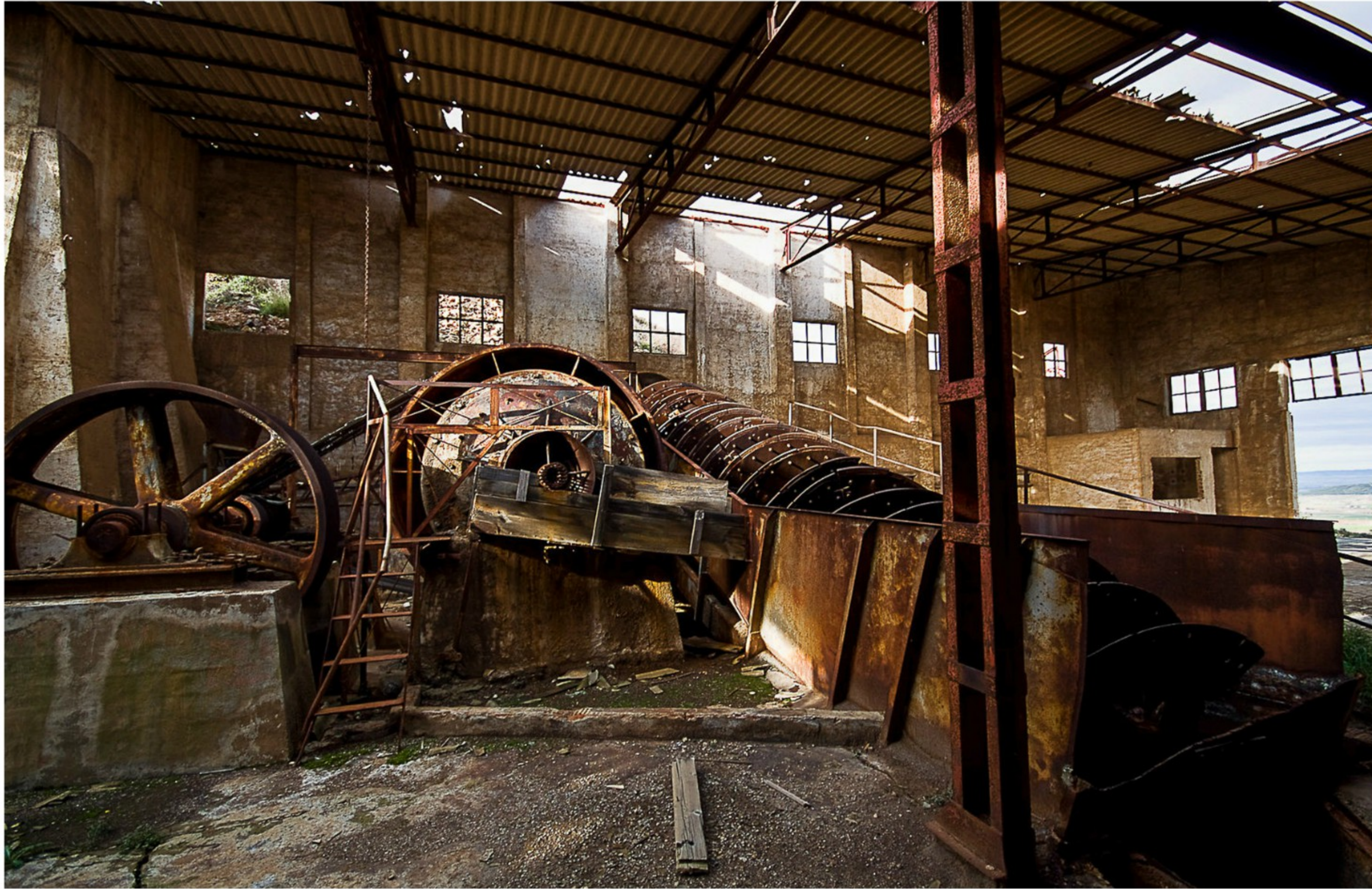
Lavadero de flotación diferencial Nuestra Señora de Monserrat, de planta rectangular, construido en ladrillo con una techumbre sostenida por estructura metálica, que cuenta con los siguientes elementos: -Motor eléctrico -Molino de bolas (Faltan cojinetes) -Tornillo de Arquímedes ó clasificador (sólo queda el eje) -Acondicionador con dos salidas
