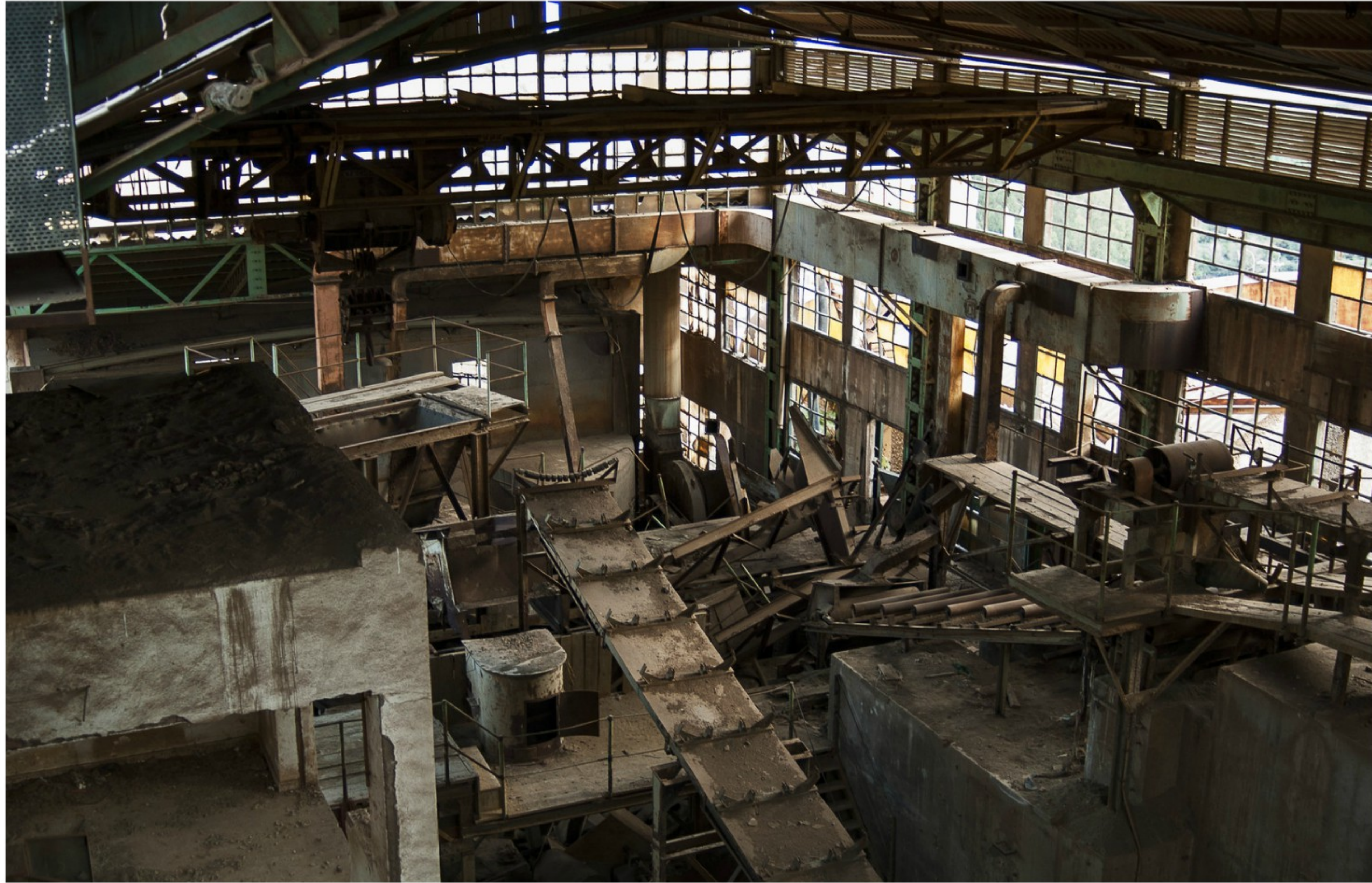
Estado interior del Lavadero Roberto - Portmán
